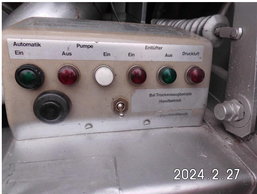
Zdj. 6. Układ sterowania pompą wodną.
